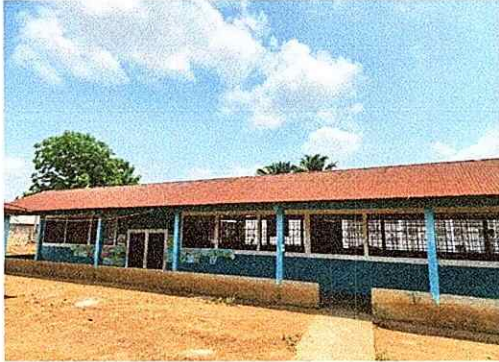
Foto 1: Cubierta de lamina en mal estado
