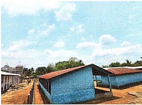
Foto 3: la estructura y cubierta de techo en mal estado
