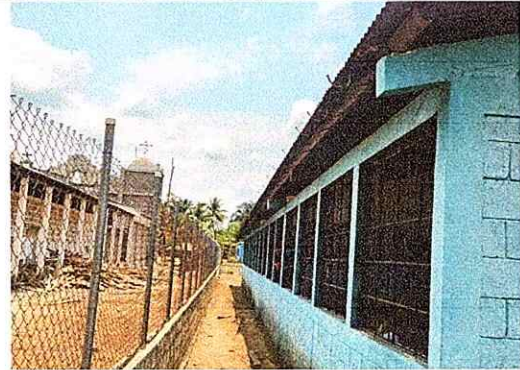
Foto 4: Estructura en mal estado
