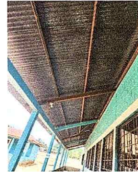
Foto 2: Estructura de techo requiere mantenimiento
